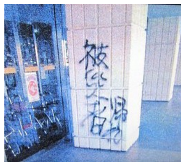
いわき市役所玄関入口に書かれた「被災者帰れ」の心ない落書き
